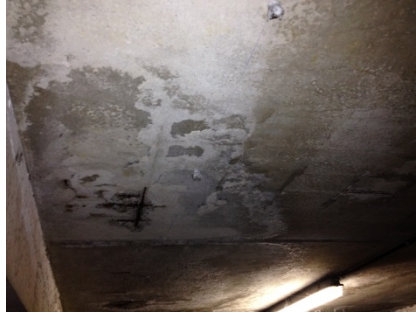
Schade door jarenlange waterinsijpeling.
