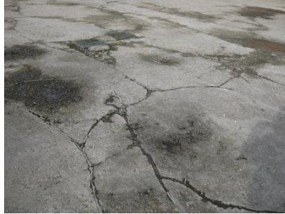
Situatie voor de renovatie - scheurvorming
