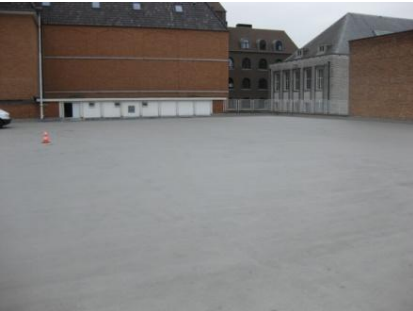
De dakparking met het Triflex ProPark variant 1 systeem
